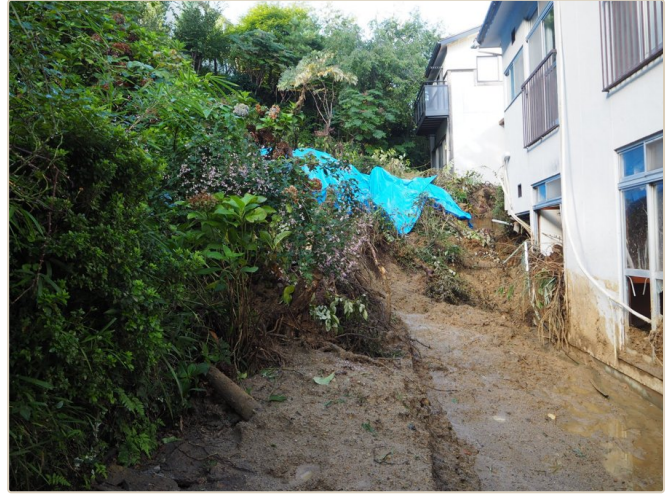
母屋のきわまで流れ込んだ土砂と、泥まみれになった外壁。
